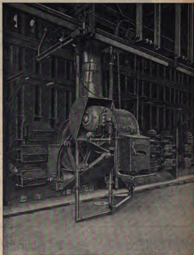
Fotografia del Caricatore De Brouwer installato all'Officina del Gas di Gracia - Barcellona.
